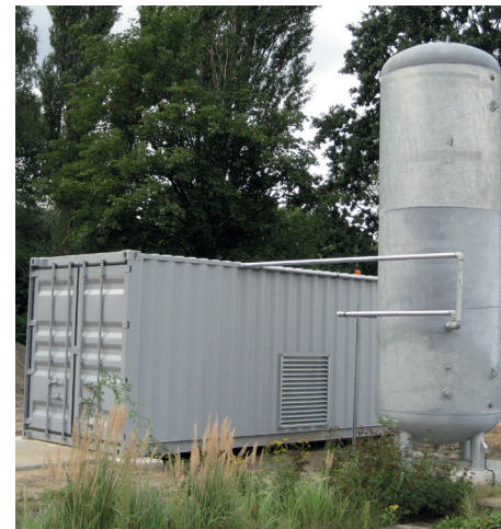
Kompressorstation mit Druckluftbehälter
