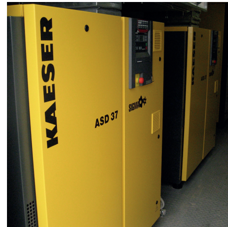
Blick in eine Kompressorstation
