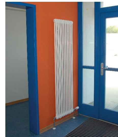
Heizkörper im Eingangsbereich
