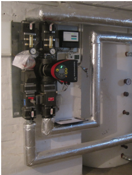
Hausanschlussstation bei Montage
