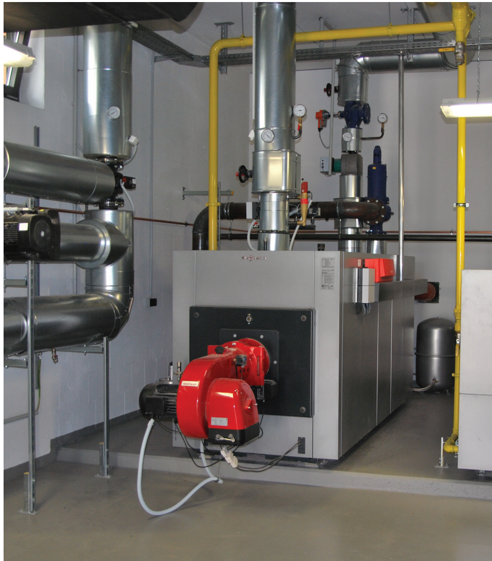
Heizhaus mit Brennwertkessel
