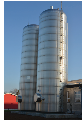
Speicher 2 x 120m
