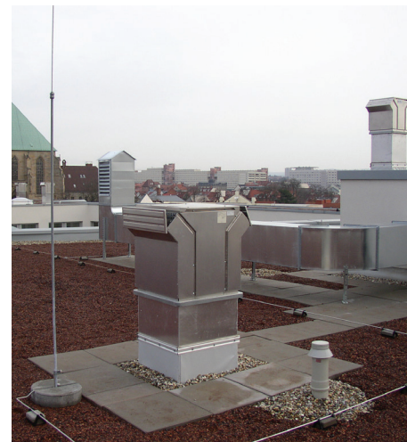
Technik auf dem Dach
