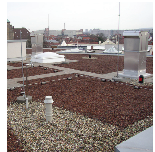
Technik auf dem Dach
